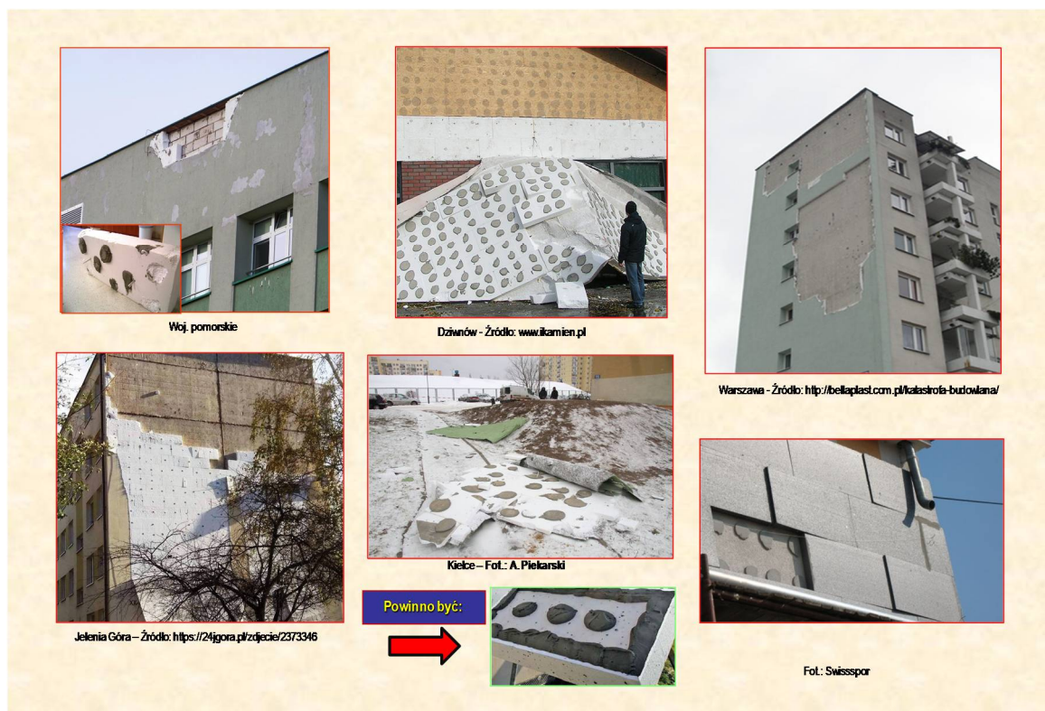
Fot. 6.2.13÷6.2.18 Skutki błędów wykonawstwa prac dociepleniowych
